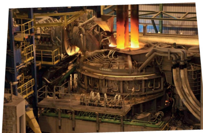
Elektryczny piec łukowy
